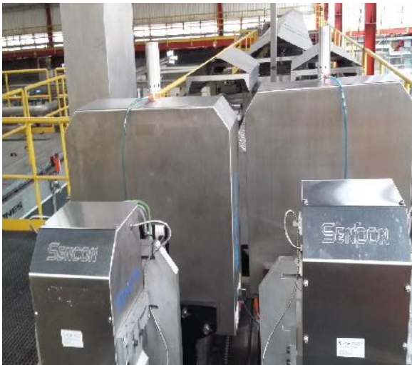
Figura 1: Equipamento sem identificação
